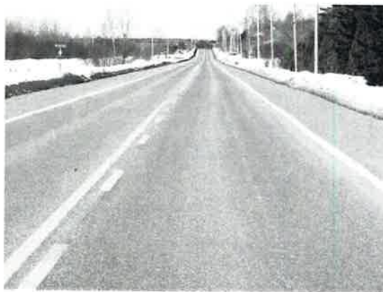
Photo 6101-2 Exemple de chaussée dégagée (route nationale)
